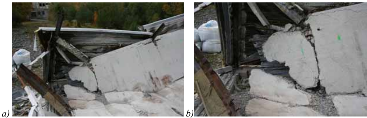
Obr. 20 Roh ocelobetonové desky, kde začalo porušení, po zřícení, a) okrajové nosníky, b) porušený roh desky
