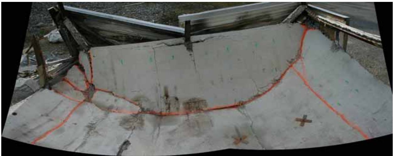
Obr. 19 Pohled na porušenou ocelobetonovou desku
